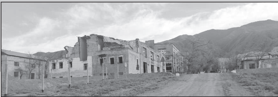
Полуразрушенные здания на территории заброшенного электротехнического завода Каджи-Сая производят мрачное впечатление.
