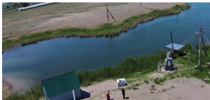
Жети-Өгүздөгү насостук станция
